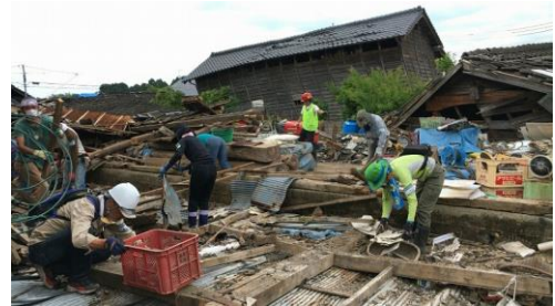
倒壊した住宅の片付け
